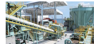
汚染土壌洗浄設備
